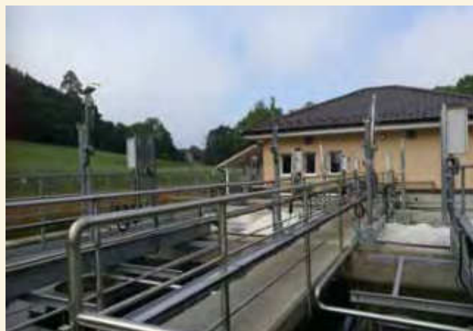
Čistička odpadních vod
